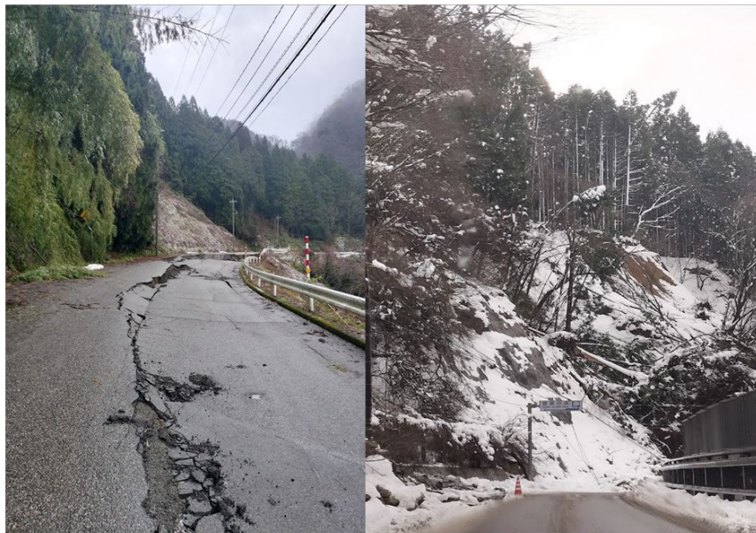
道路損壊と斜面の崩落が多発
